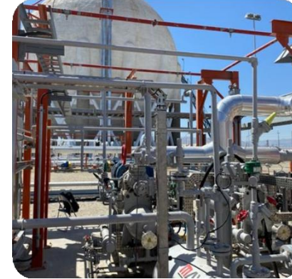
Ejemplo de un sistema de relicuación para almacenamiento
