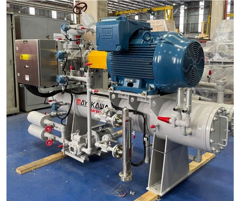
Unidad de transferencia de NH 3
