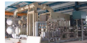
LNG BOG Compressor - Turkey 400S / 830kW
